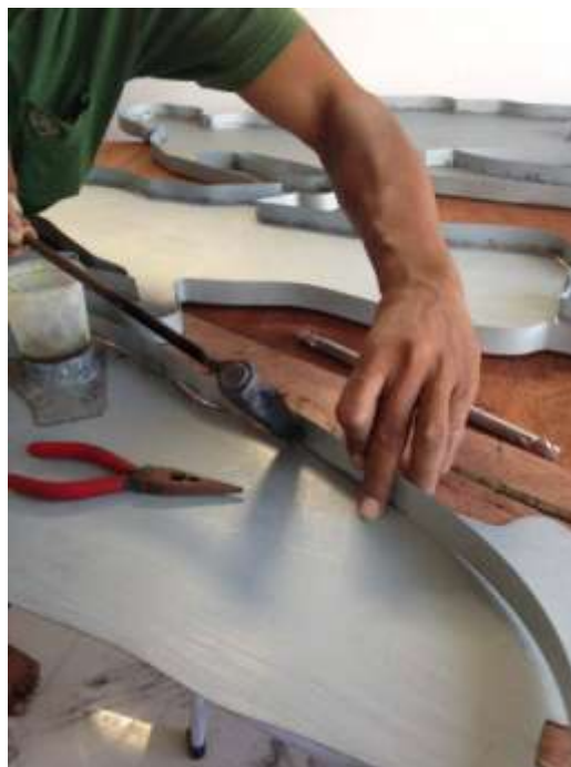
ภาพที่ 3-27 จากนั้นใช้ค้อนที่มีความร้อนจากการเผาไฟ จี้กับแท่งตะกั่วและนำเนื้อตะกั่วที่ติดกับปลายค้อนมาจีกลงบนแผ่นเหล็กซิงค์เพื่อให้แผ่นเหล็กซิงค์ติดกัน
