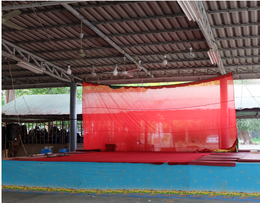
ภาพที่ 4-5 การติดตั้งไฟราวลำตัดและเวทีขนาดสูง 1 เมตร
