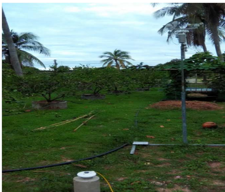
ภาพที่ 3-29 การติดตั้งเครื่องมือวัดสภาพอากาศ
