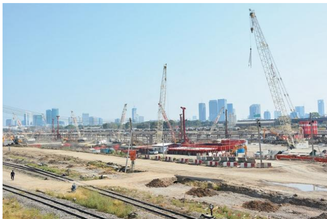
ภาพที่ 3-3 การก่อสร้างเข็มเจาะในโครงการระบบรถไฟฟ้าชานเมือง สายสีแดง บริเวณ สถานีกลางบางซื่อ
