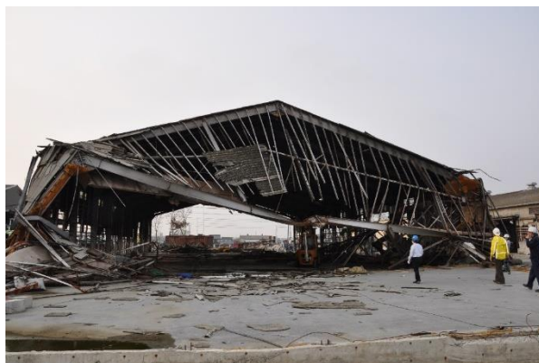
รูปที่ 1.1 ความเสียหายของอาคารเหล็กภายหลังการเกิดแผ่นดินไหว
