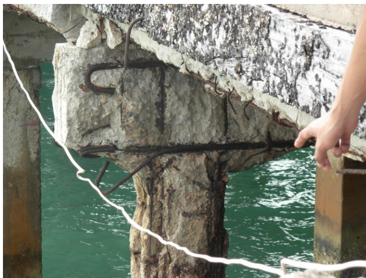
รูปที่ 2.4 ลักษณะการทำลายของสารประกอบซัลเฟตต่อคอนกรีต
