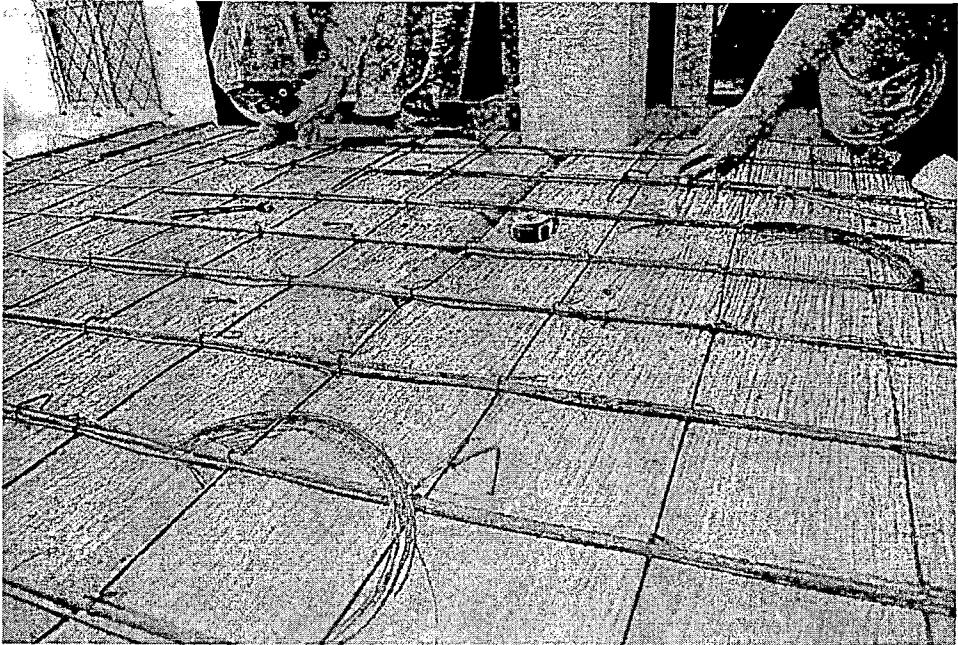
รูปที่ 3.17 การติดตั้งเหล็กตะแกรง (Wire mash)
