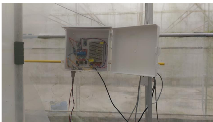
ภาพที่ 3 การติดตั้งระบบควบคุมปั้มน้ำและพัดลมระบายอากาศของระบบการระเหยของน้ำและระบบสเปรย์น้ำ โดยการโปรแกรมลงบอร์ดไมโครคอนโทรลเลอร์ทำงานร่วมกับอุปกรณ์ เซ็นเซอร์อุณหภูมิและความชื้นให้สามารถส่งการควบคุมระยะไกลผ่านอินเทอร์เน็ตได้
