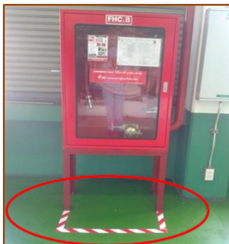
ภาพที่ 4-11 ความปลอดภัยหลังการแก้ไข
