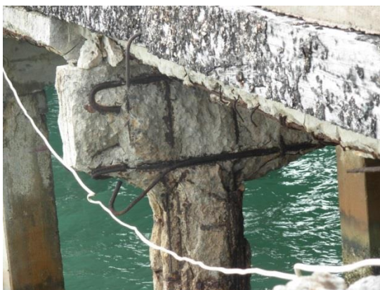
รูปที่ 2.1 โครงสร้างคอนกรีตเสริมเหล็กถูกทำลายเนื่องจากสิ่งแวดล้อมทะเล
